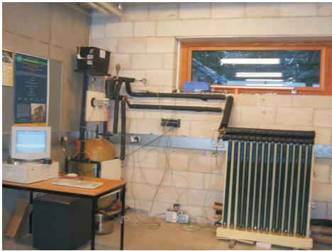
图7 利用环式毛细热管技术的分体式太阳能真空管阳台热水系统
